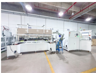
03. Гелиевая установка контроля распределительных коллекторов
