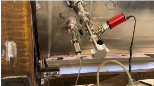
Подключение измерителя к криогенному резервуару
