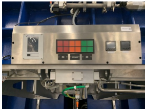
Панель управления газовой системой
